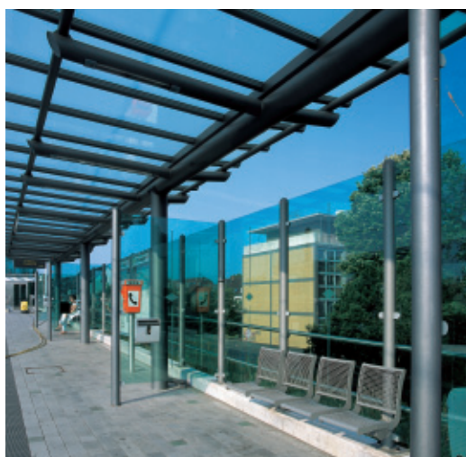
Duisburg, Stadtbahn Rhein-Ruhr: Überdachter Wartebereich, 2 Jahre nicht gereinigt.
